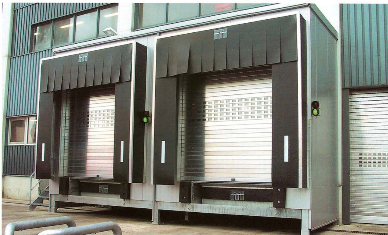
Doppel-ISO-Haus mit Rolltor vorne. Standard-Überladebrücken MTV, verzinkte Ausführung.
