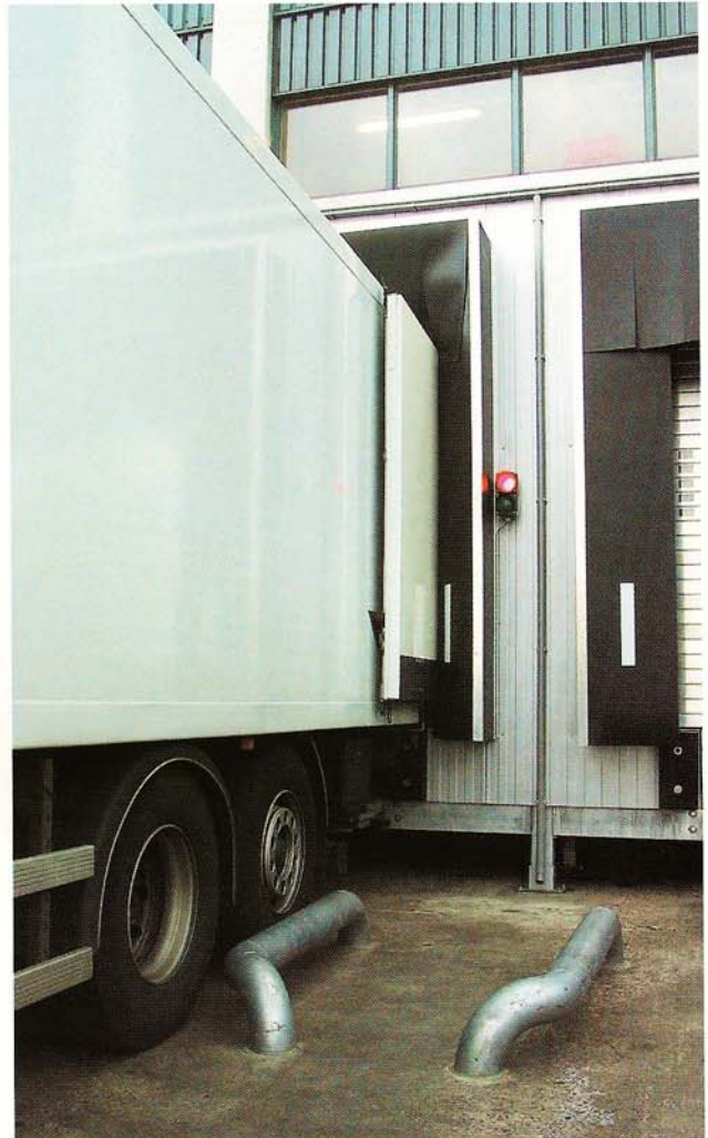
LKW-Einfahrhilfen mit Sicherheitsampelanlage.
